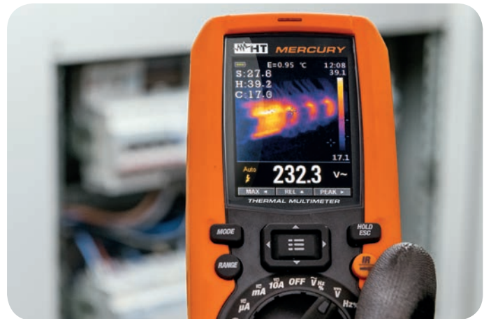
Análisis Termográfico de los dispositivos de seguridad de un Cuadro Eléctrico.
