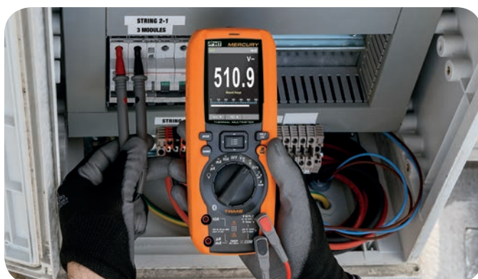
Módulos Fotovoltaicos: Medida de Voc.
